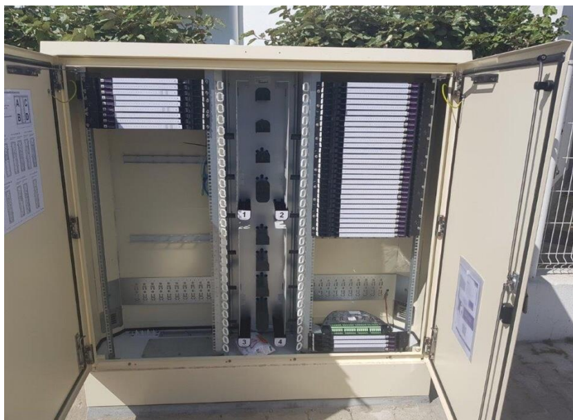
armoires fibre optique
